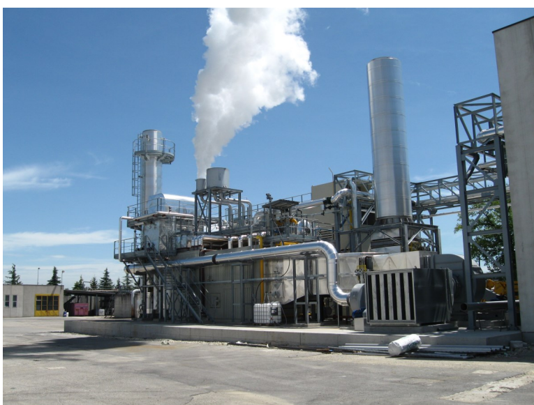
Generatore di vapore a recupero da turbina a gas
