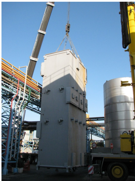
Generatore di vapore a recupero da fumi di raffineria
